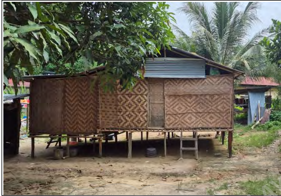
Rajah 3.15 Rumah yang mempunyai dinding berlubang dan bumbung bocor menyebabkan air hujan kerap kali membasahi kawasan dalam rumah
